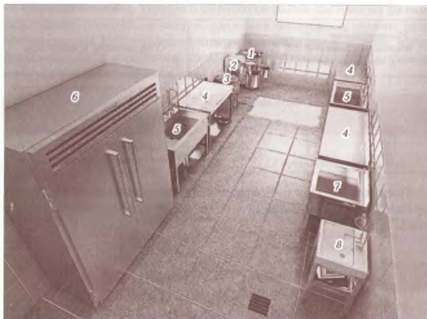
Рис. 4.12. Техническое оснащение доготовочного цеха:
