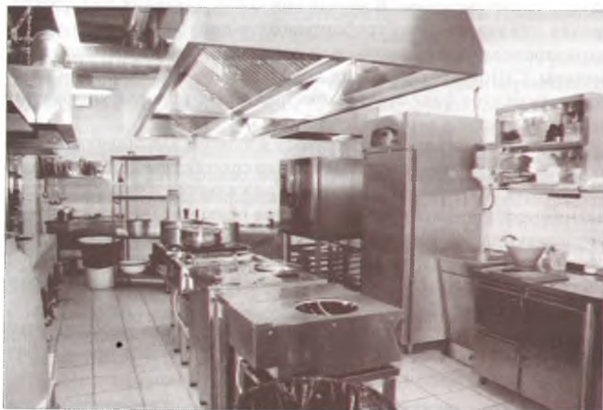
Рис. 8.2. Тепловая линия горячего цеха, соусное отделение (пастакукер, вставка секционная, плита электрическая, пароконвектомат)
