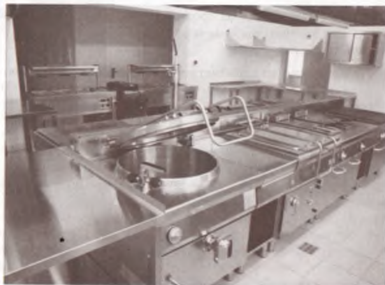
Рис. 8.3. Тепловая линия горячего цеха (пищеварочный котел, сковорода с непосредственным обогревом)
