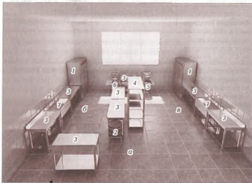
Рис. 4.11. Техническое оснащение мясо-рыбного цеха:
