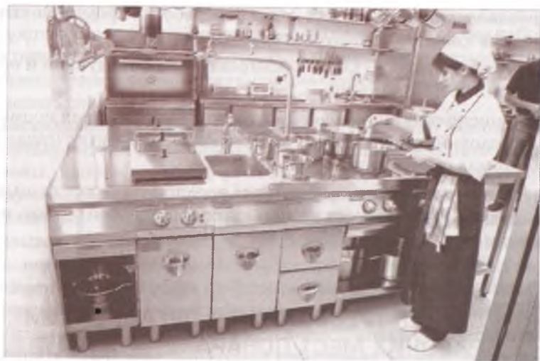
Рис. 2.4. Рабочее место повара в горячем цехе (фритюрница электрическая секционная модулированная, встроенная производственная ванна, плита электрическая, шкаф жарочный электрический)
